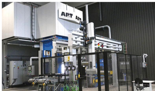
Ligne d'emboutissage à chaud
